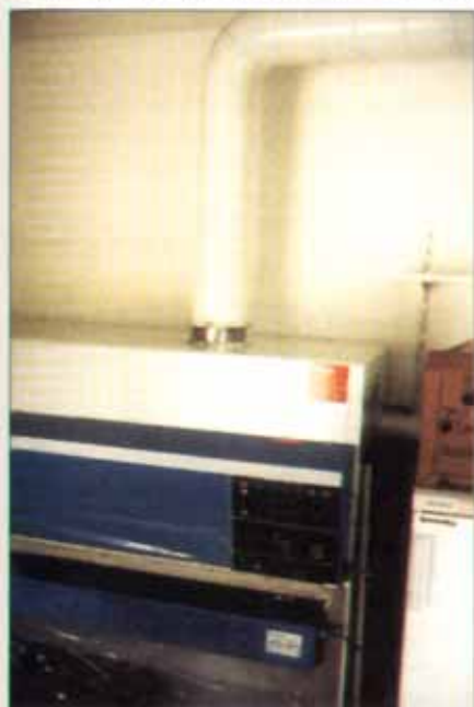
Bild 5: Eine Swb der Klasse 2 direkt an ein Fortluftsystem angeschlossen → Kein Personen-, Produkt- und Verschleppungsschutz!
